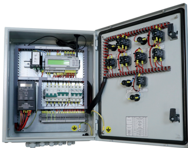
Рис. 4. Внутренний вид шкафа для автоматизированного узла управления
